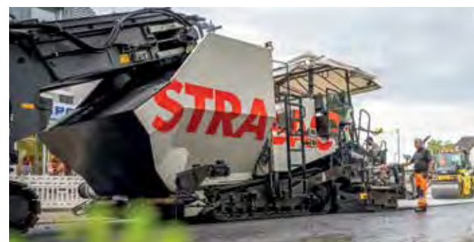
Der schadstoffmindernde Asphalt nutzt Titandioxid als Photokatalysator, der unter UV-Licht, also bei Sonneneinstrahlung, reagiert und Stickoxide dabei in unschädliche Nitrate umwandelt.
