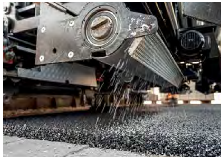
Der fertigungsintegrierte Streuer der Strabag AG bindet direkt bei Asphaltbau das photokatalytische Material in die Oberfläche. „Clean Air“-Asphalt soll Stickoxide absorbieren.
